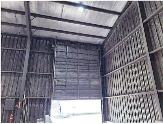
Broken Load Out Door
